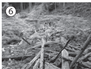
⑥ 「みえ森と緑の県民税」土砂・流木緊急除去事業(加太板屋字千代が萩)
