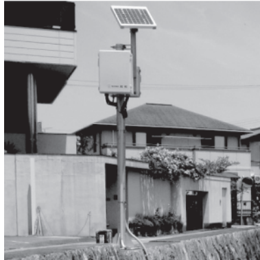
堤防に設置するタイプ (ケーブル(計測器)を河川 に入れて計測)
